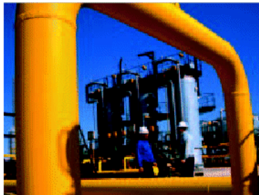
Gassi El Agreb, Algeria
